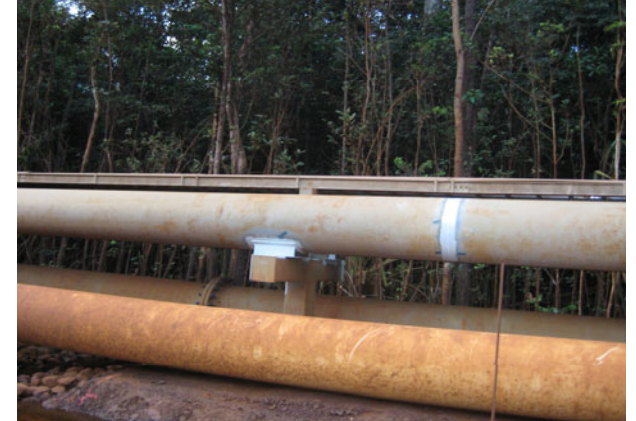
特別植物保護区端を横切るパイプ(看板撤去2009・4)
