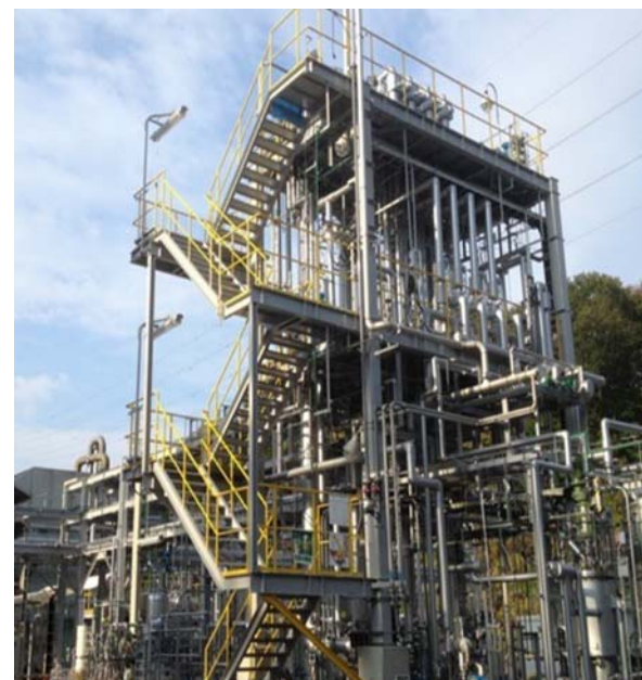
実証プラント
